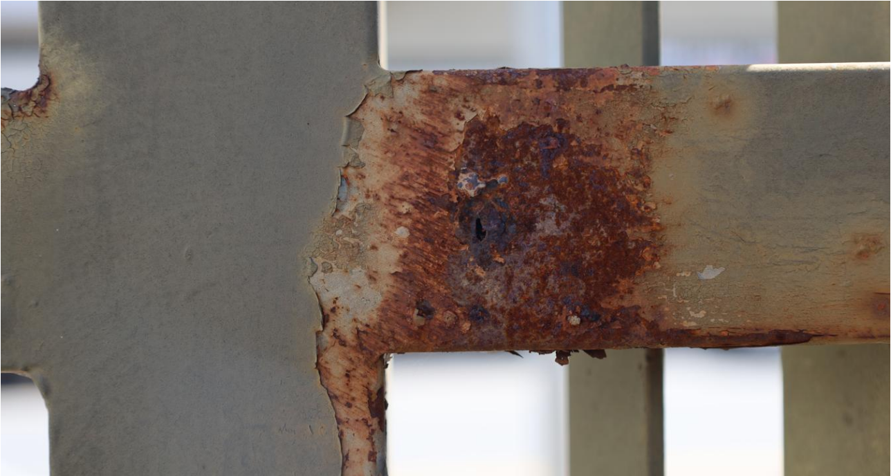
Figura 4.3c Acúmulo de ferrugem, com metal já perfurado
