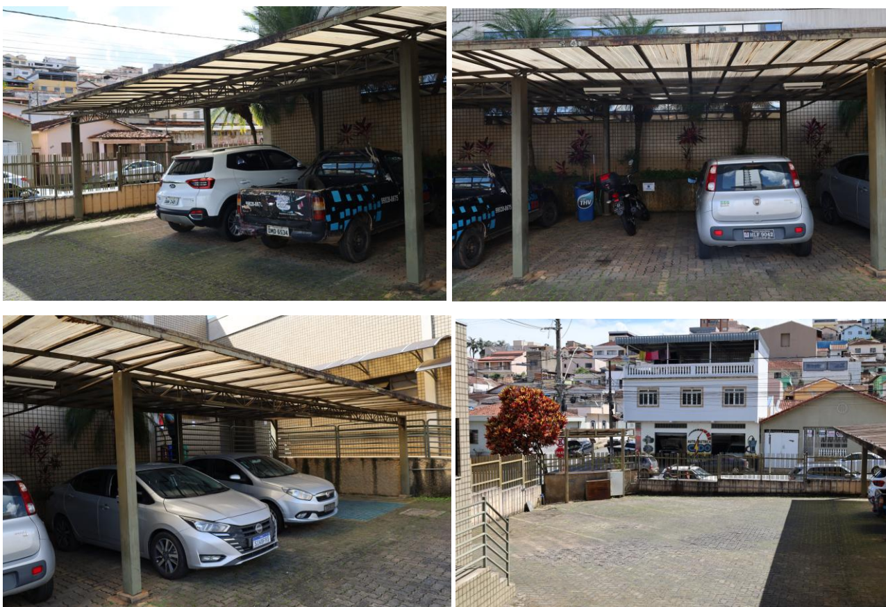
Figura 5.15 a-d Estrutura metálica da cobertura das vagas de garagem do estacionamento dos vereadores; vista geral do estacionamento
