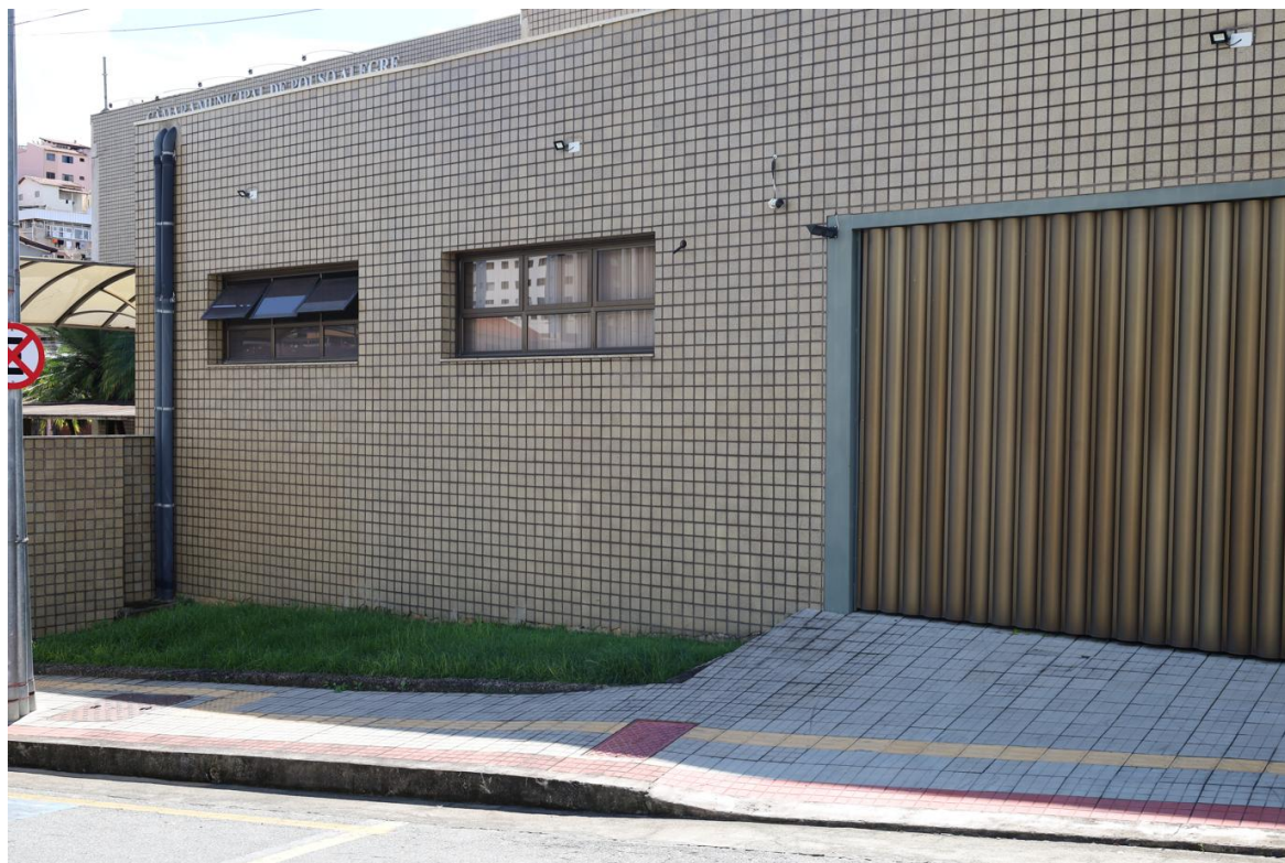
Figura 5.3 Portão da garagem coberta (não está incluído nesta contratação, pois sua composição dispensa pintura); Rua Luiz Carlos Reis
