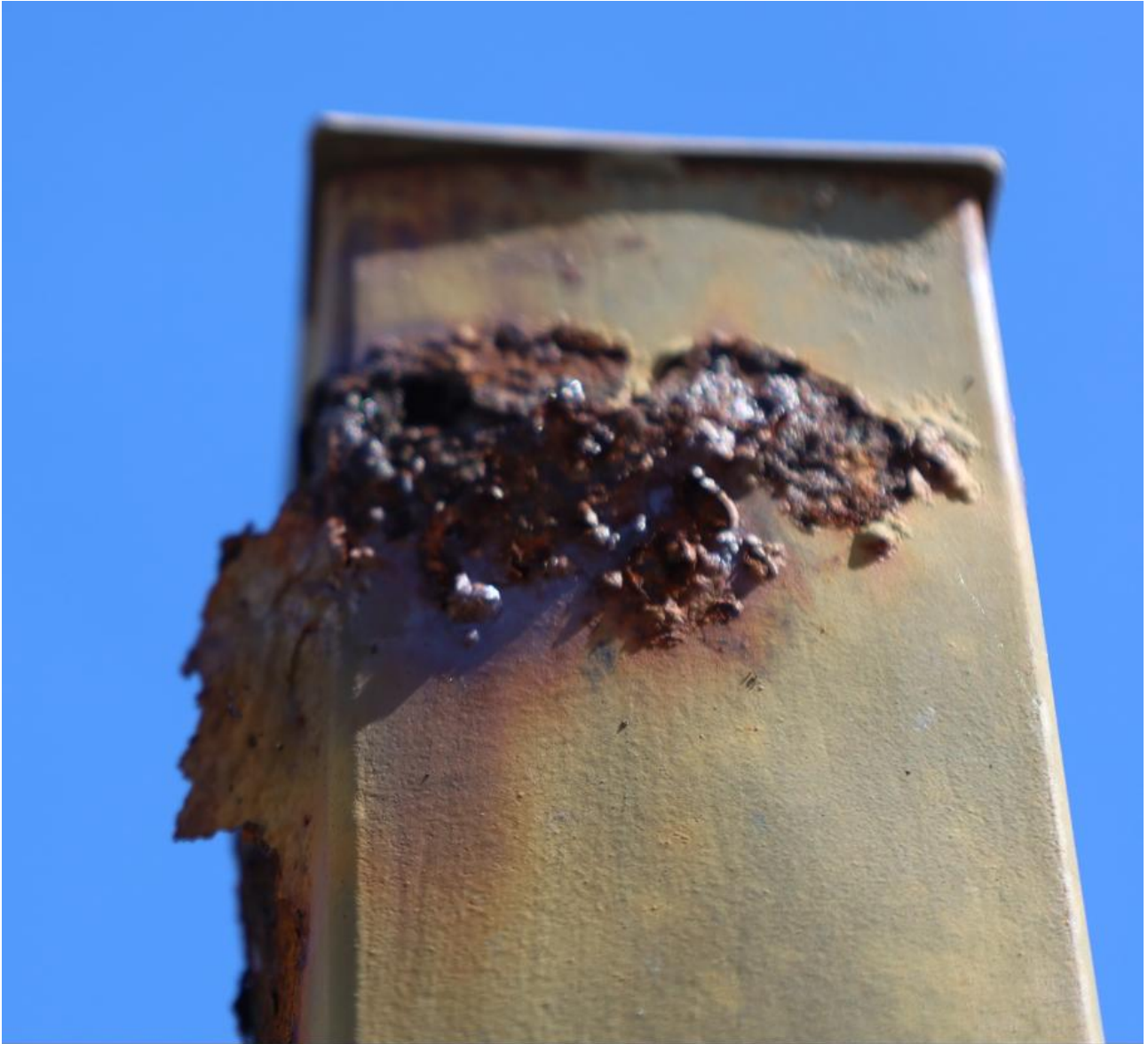
Figura 4.3b Acúmulo de ferrugem em cabeça de coluna
