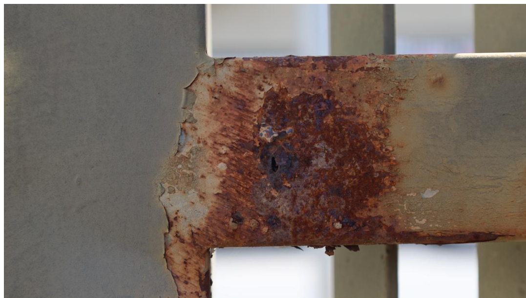
Figura 4.4b Furo em tubo de metalon (espessura do tubo de cerca de 5 cm)
