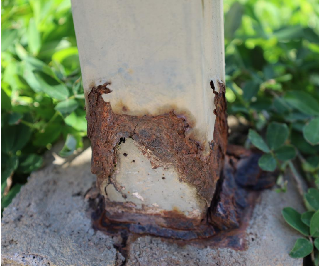
Figura 4.3a Acúmulo de ferrugem
