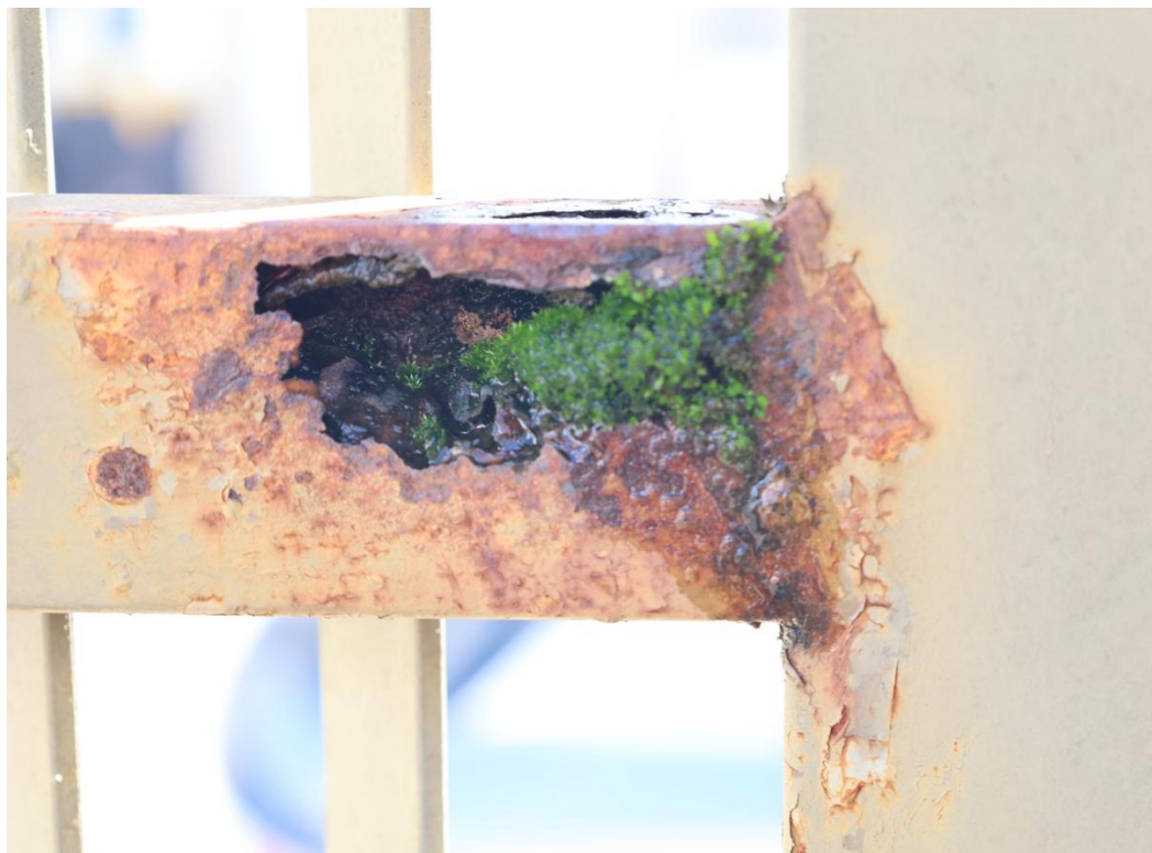
Figura 4.4a Buraco causado pela corrosão. Para efeitos de escala, a espessura do tubo é de cerca de 5 centímetros.
