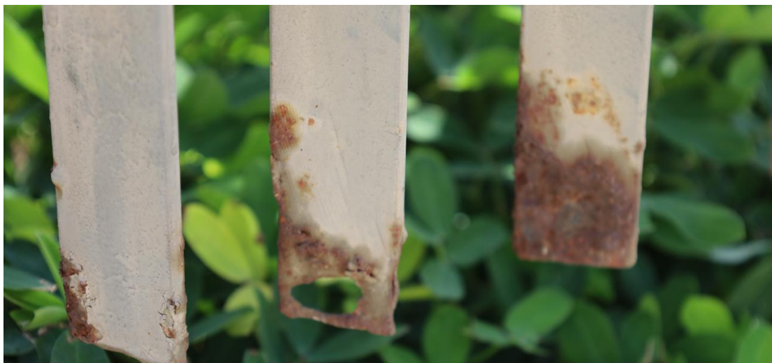
Figura 4.5a Corrosão e furo na extremidade inferior de barra chata (para efeitos de escala, espessura da barra chata de aproximadamente 1 ¼")
